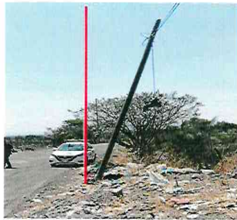
Figura 4.4: Comunicación CS y AEPT, infraestructura sin mantenimiento
