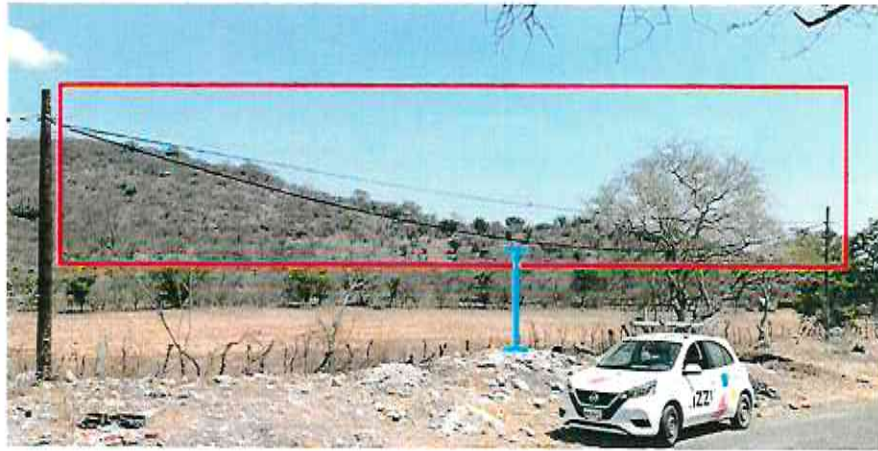
Figura 4.5: Comunicación CS y AEPT, infraestructura sin mantenimiento
