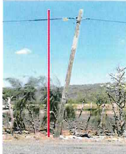
Figura 4.4: Comunicación CS y AEPT, infraestructura sin mantenimiento
