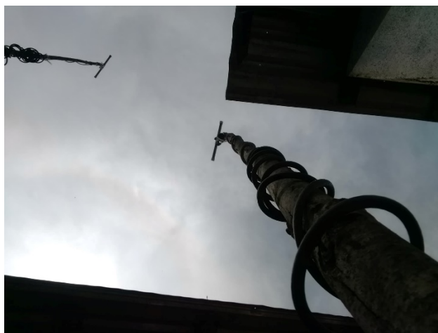
Figura xxx. Antena para recibir señales de televisión abierta
